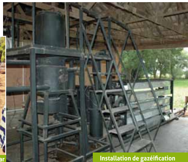
Installation de gazéification
